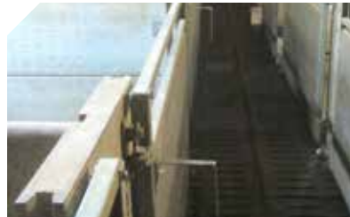
Des marqueurs positionnés avant le passage du robot permettent de jouer le rôle de guides
