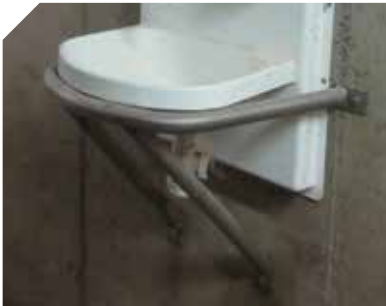
Le support galva protège le lave-mains lors des passages d'animaux dans le couloir
