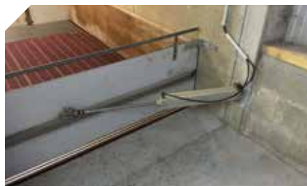
Vue du vérin pneumatique
