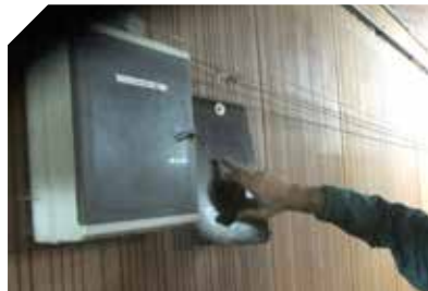
Les bons Uniporc sont stockés dans une boîte fixée au mur
