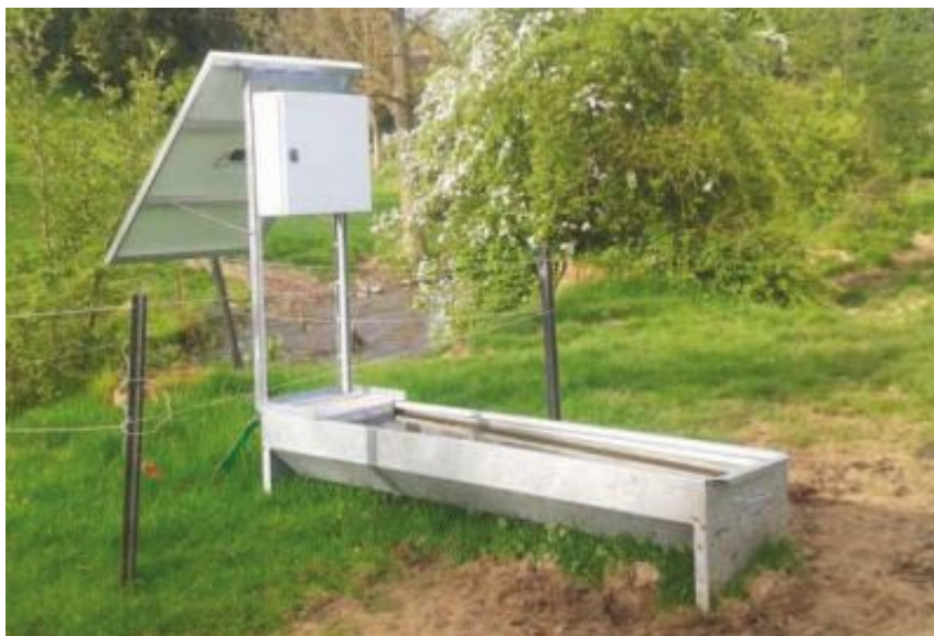
abreuvoir en prairie avec le système photovoltaïque
