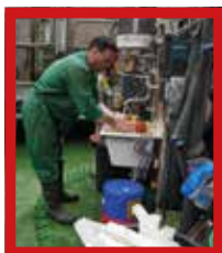
Evier installé trop bas
